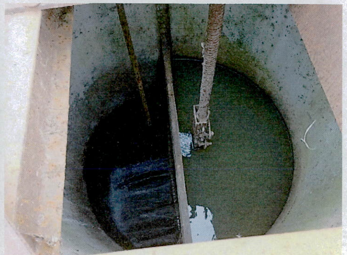
spillway slide gate
